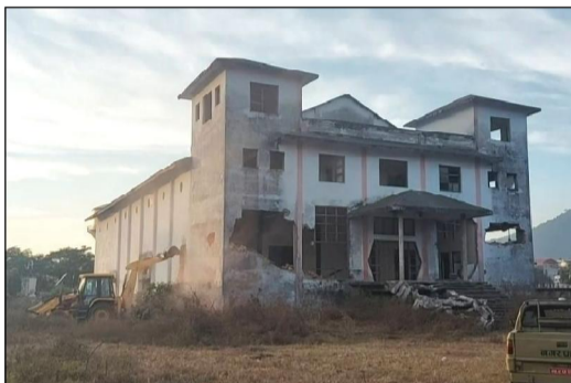
मकवानपुरका हेटीडामा तत्कालीन शाहीकालमा निर्माण गरिएको हेटीडा-४ हुन्न (लोकतान्त्रिक चौर) स्थित 'बाबुदेव सम्भाग' भन्दापछि हेटीडा उपमहानगरपालिकाले सोही स्थानमा भ्यूटारसहितको १२ तले व्यापारिक भवन निर्माण गर्न थालेपछि बाबुदेव सम्भाग भन्दा नुहाइ नुहाइ आएको हेटीडा उपमहानगरपालिकाको हीमाले सँगसँगै तल्लो हिमालमा भएको छ।
